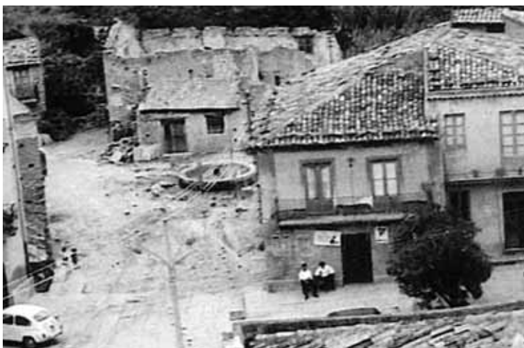
Fig. 23 - Basicò - Particolare della Chiesa di Santa Maria che presenta la totale assenza del tetto e delle travi.
