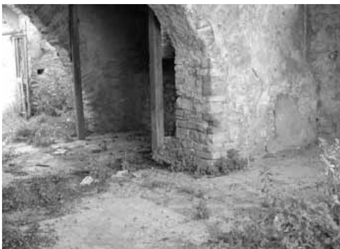
Fig. 19 - Basicò - Particolare degli stipiti rinforzati al tempo della costruzione della sovrastante terrazza.
